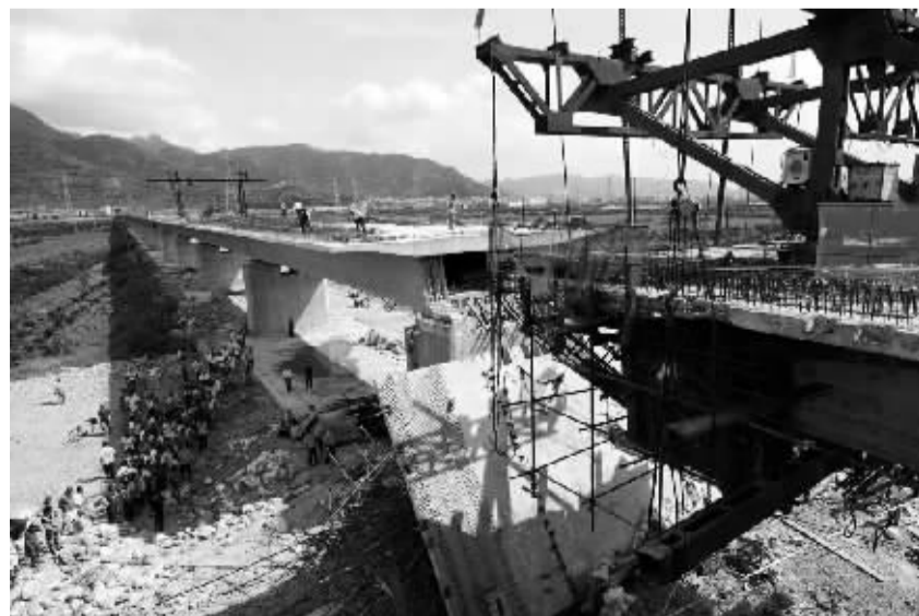
一段长约 12 米的桥梁板已经完全倒塌下来
